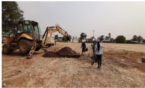
Foto: Mantenimiento de tubo por ruptura
